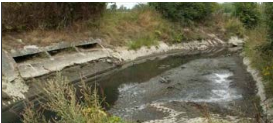
Kloakoverløb til Harrestrup Å
