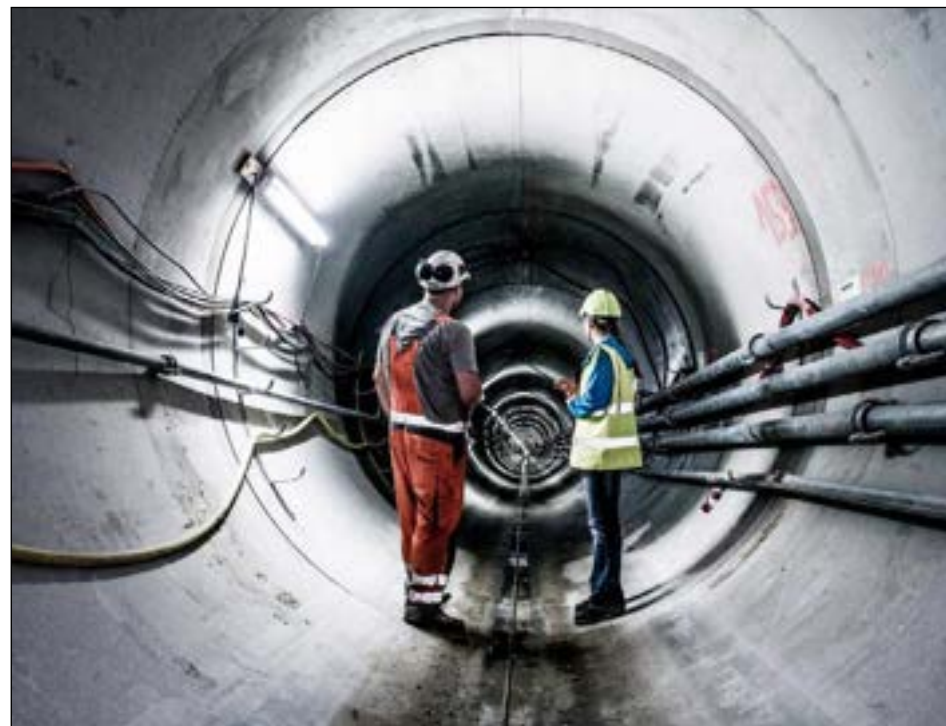
Svanemøllen Skybrudstunnel er færdig i 2031. Den bliver et stort og mange kilometer langt rør, som kan aflaste de almindelige kloakker ved skybrud. Forløbet heraf bliver y-formet, og det nordligste ben skal aflaste især Gladsaxe og Gentoftes Kommuner.
