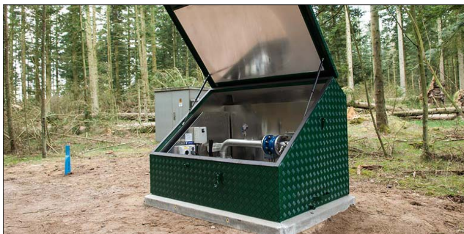
At finde vand er sommetider lidt lunefuldt, men når boringen er på plads, fylder et pumpeanlæg ikke mere end en lille boks som denne.
