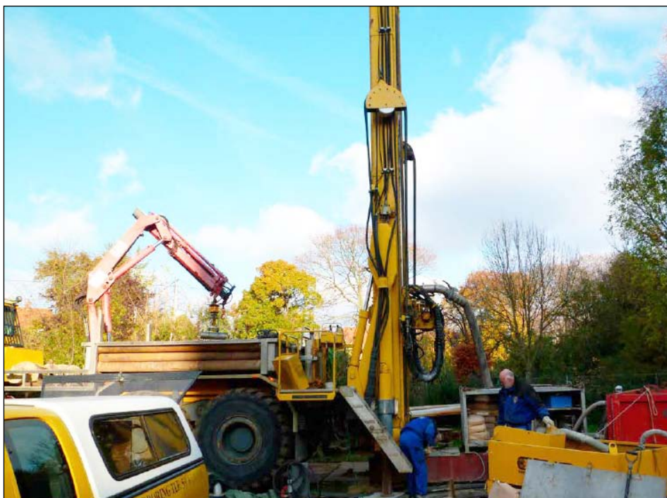
Moderne boreudstyr. Når boringen er gennemført, kræver et anlæg minimal vedligeholdelse. Hvis vandets tryk ikke kan drive anlægget, kræver det dog energi til en pumpe.
